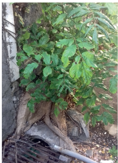
Dégât causé par un Tulipier du Gabon sur une canalisation
